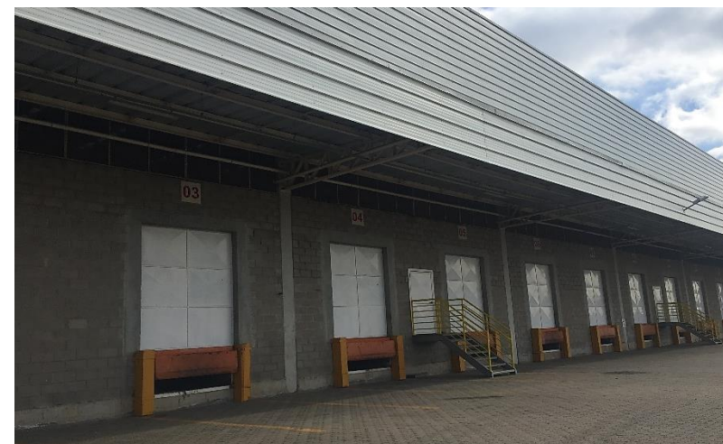
DOCAS COM NIVELADORAS ELÉTRICAS
