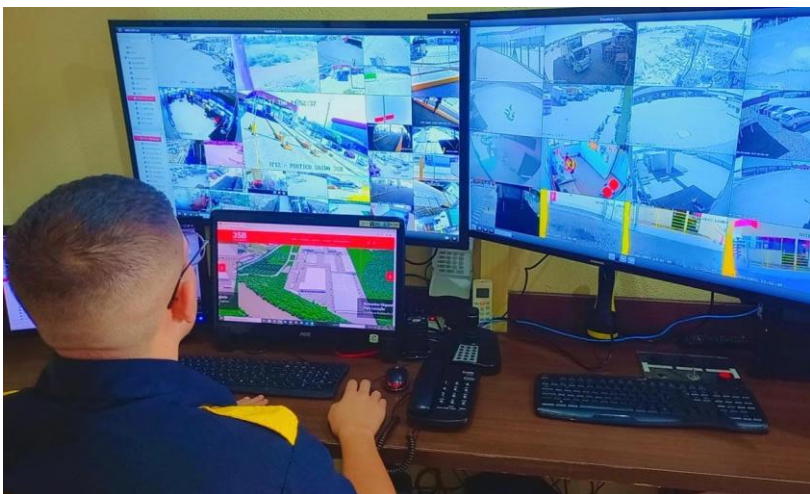
SISTEMA DE MONITORAMENTO INTERNO E EXTERNO
